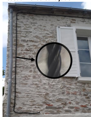
Réseau fils isolés façade BT
