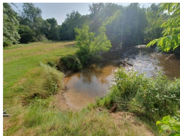
Vue de l'érosion de la berge (20/06/2025)
