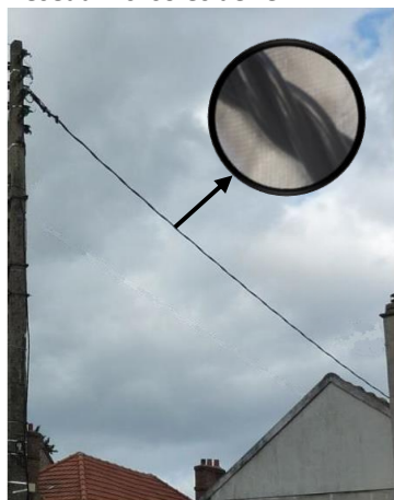
Réseau fils isolés aérien BT
